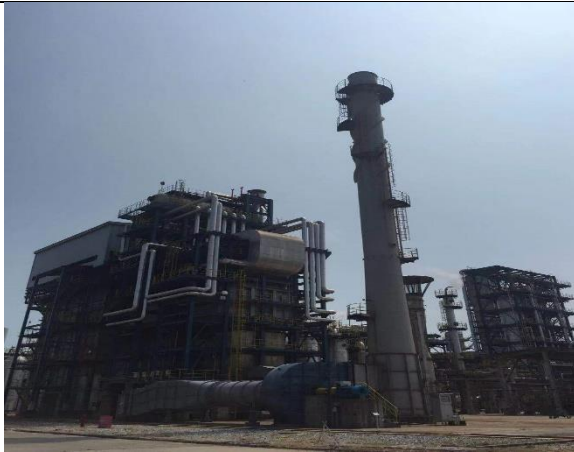
制氢装置转化炉
