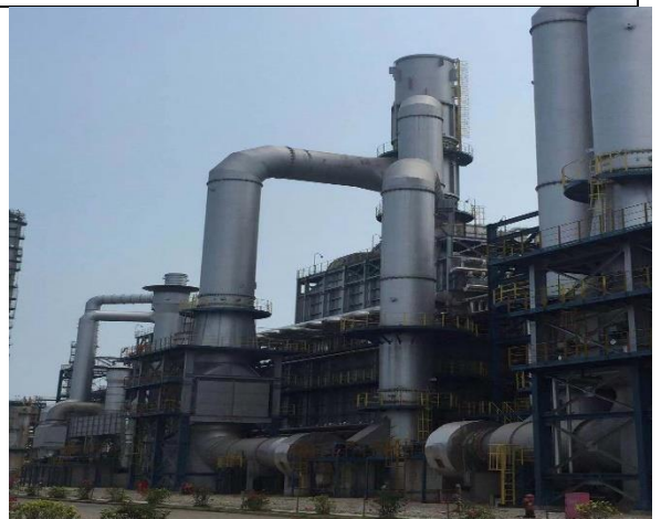
吸附分离装置 1 二甲苯分馏塔重沸炉
