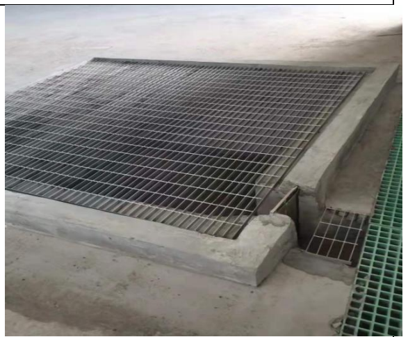
暂存间内收集池
