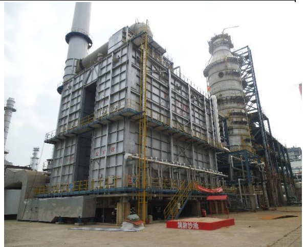
凝析油分离装置分馏塔重沸炉
