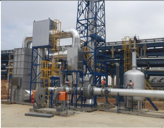
“三苯”储罐废气设施
