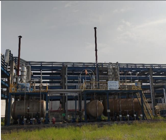
罐区脱臭设施
