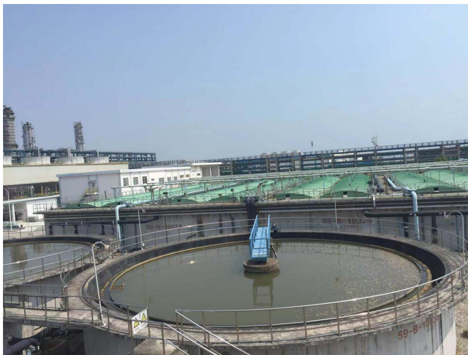
图 4-8 含油污水处理场
