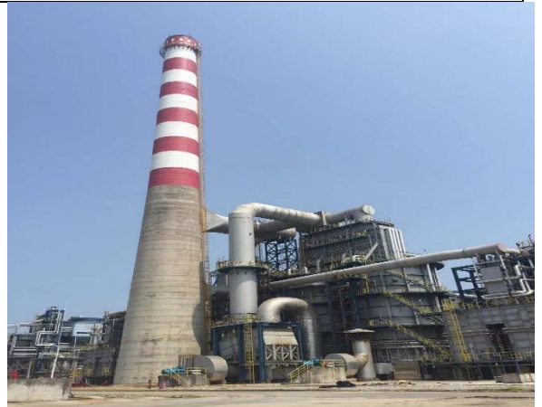
加氢裂化装置加热炉
