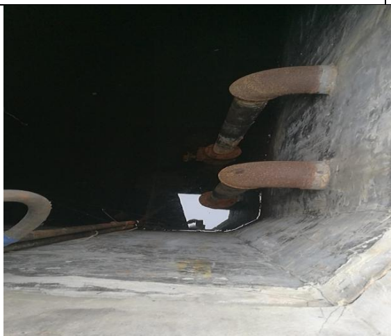
事故水提升泵及提升管
