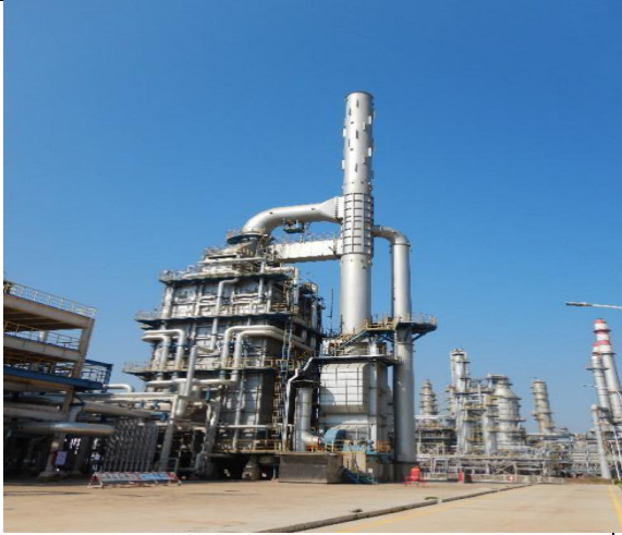
凝析油加氢装置进料加热炉
