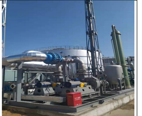
污水处理场脱臭设施
