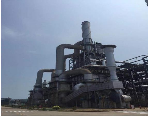
吸附分离装置 2 二甲苯再蒸馏塔重沸炉
