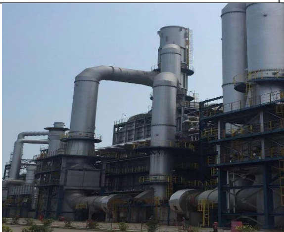
吸附分离装置 1 二甲苯再蒸馏塔重沸炉
