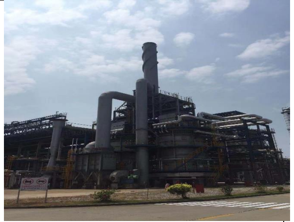
歧化及烷基转移装置反应器进料加热炉
