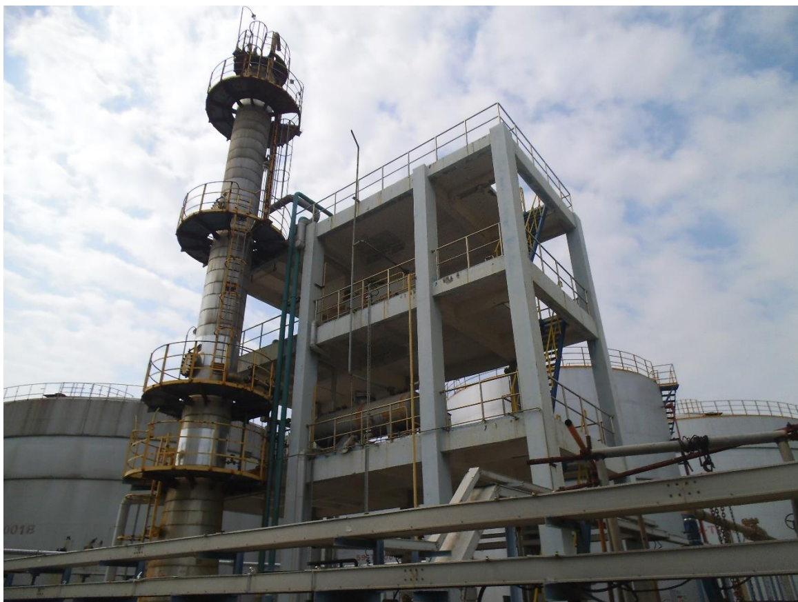
图 4-6 含 BTX 污水处理设施
